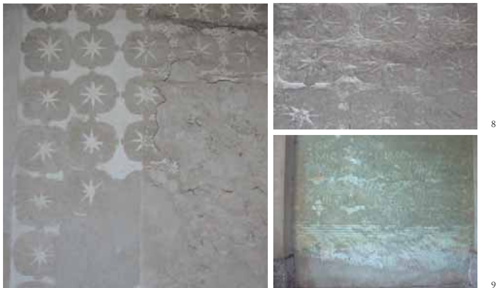
7-8. La parete con evidenti i segni di degrado
