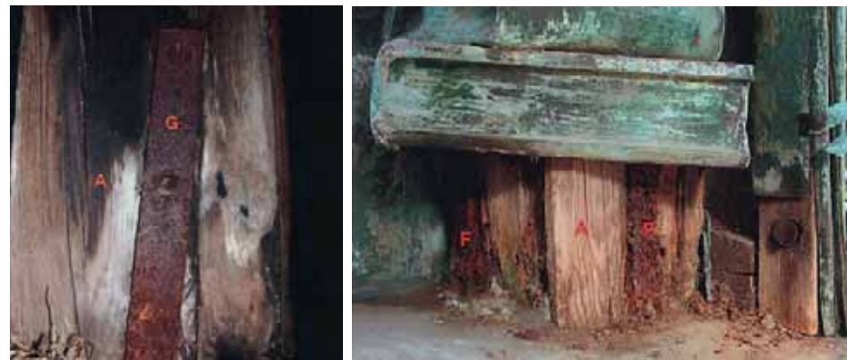
5. L'interno della base della statua di Bernardino Caimi che mostra evidenti i segni del degrado della struttura
