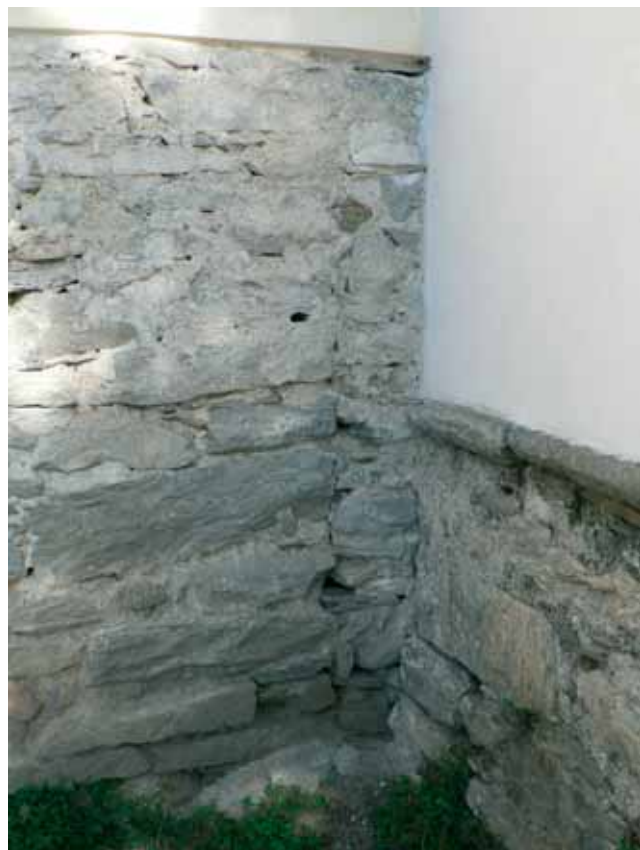
Fig. 48. Ghiffa, SS. Trinità, stacco verticale nella muratura sud dell'edificio.
